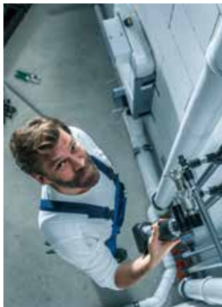
Impianti per acqua potabile:
