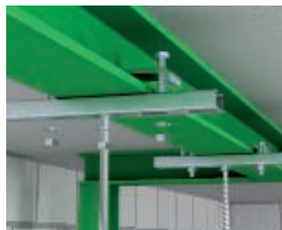
Fissaggio su acciaio di profilati a C Fissaggio di un profilato a C tipo CPS 4 G o CPS 5 G ad un supporto in acciaio con l'ausilio di un angolare di fissaggio tipo KWS.
