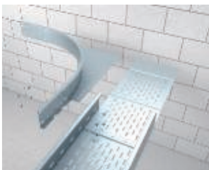
Realizzazione di una derivazione a T con curva Montaggio della prima curva tipo WEAS 110.
