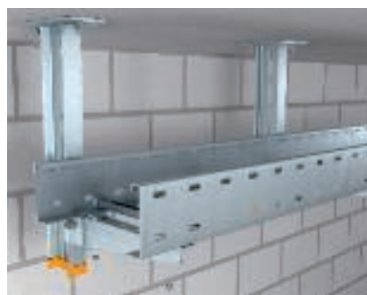
Fissaggio passerella a grande portata Fissaggio su mensola della passerella a grande portata con dispositivo di fissaggio tipo LKS 60/5.
