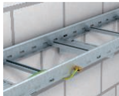
Morsetto di terra/collegamento di terra Morsetto di messa a terra per il fissaggio del cavo di terra sulle passerelle grigliate.
