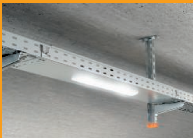
Sistemi di passerelle per corpi illuminanti
