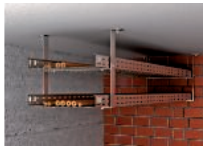
Installazione a soffitto a due strati con staffa di sospensione e staffa intermedia
