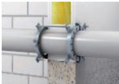
Disposizione sui due lati dei collari per tubi in caso di montaggio a parete
