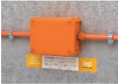
Scatola FireBox installata con etichetta di contrassegno
