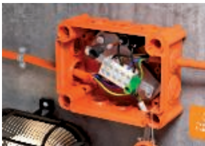
Ingresso cavi con passacavi morbidi
