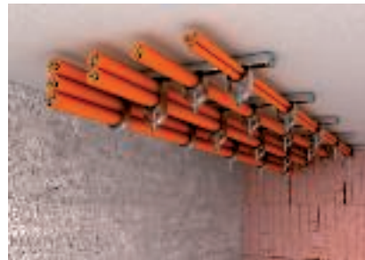
Montaggio orizzontale dei cavi con staffe reggicavo sotto il soffitto
