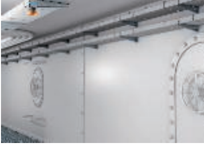
Impiego dell'isolamento in ambienti aggressivi, ad esempio Offshore
