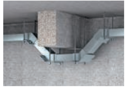
Installazione sospesa con curve verticali
