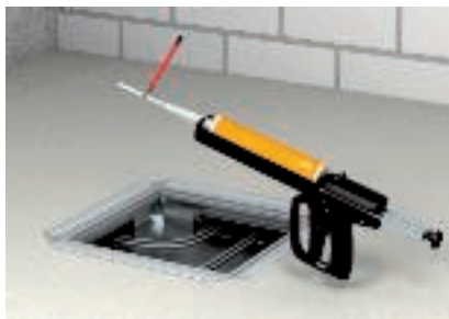
Utilizzo del tubo miscelatore con prolunga per l'applicazione di schiuma antincendio
