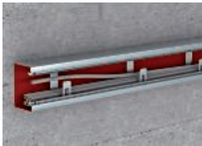
Graffe di fissaggio come supporto di installazione contro la caduta dei cavi
