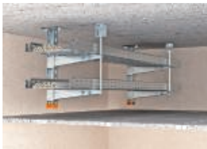
Sospensione a soffitto a due strati con disposizione mensole su un lato
