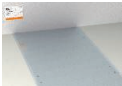
Isolamento non visibile in condotti sotto pavimento a livello del massetto
