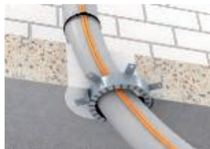
Impianti di posta con 2 cavi e tubi
