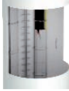
Passerella a spalliera con rivestimento isolante nella torre di un impianto eolico
